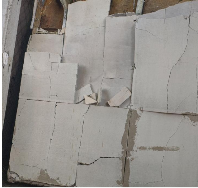
Рис. 3.12 Растрескивание обшивных материалов идёт вдоль точек креплений
