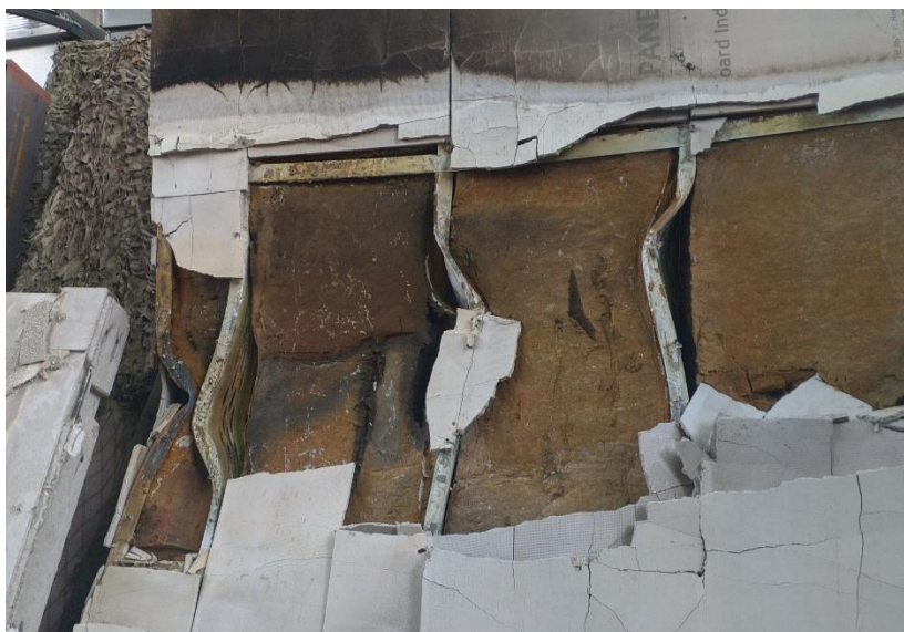
Рис. 3.9 Отсутствие деформационных зазоров привело к растрескиванию обшивного материала сразу на большой площади со стороны обогрева.
