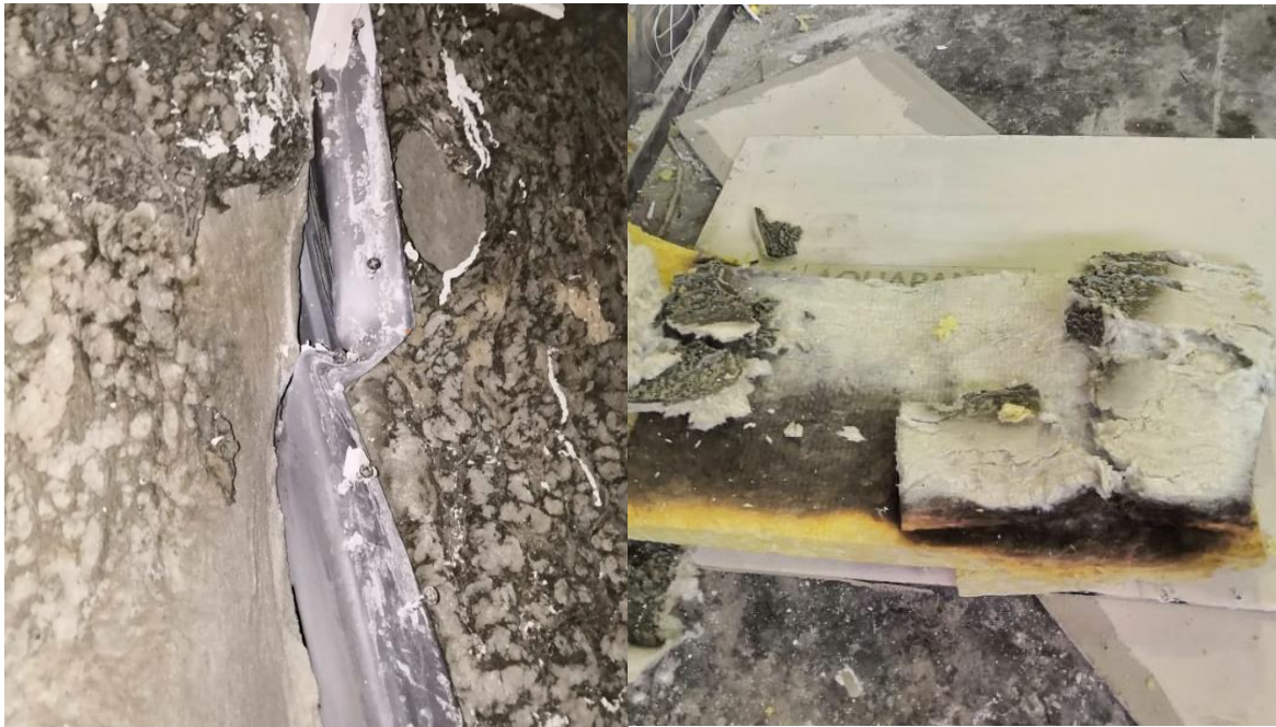
Рис. 3.5 Минеральная вата сжалась и обнажила конструкции при испытании, в результате начался прямой прогрев металлического каркаса КОС.
