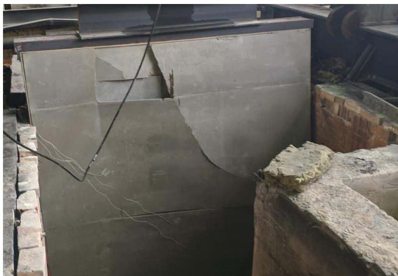
Рис. 3.8 Отсутствие деформационных зазоров привело к растрескиванию обшивки как со стороны обогрева, так и с необогреваемой стороны.
