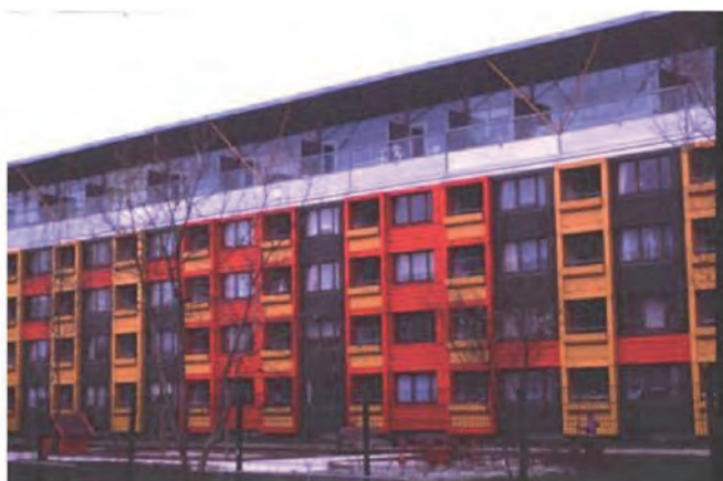
Установка новой крыши поверх старой и новой фасадной системы на старый фасад четырехэтажного жилого здания в Дании
