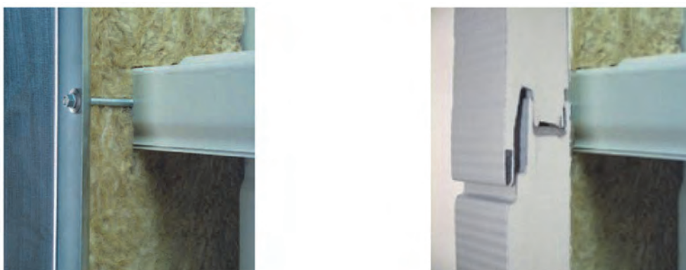
Рис. 4.26. Установка новой фасадной системы с применением кассет или сэндвич-панелей (слева и справа соответственно) на старый фасад
